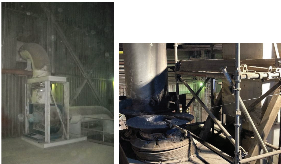
Figuur 7: Emissiepunten tijdens opstoken ruwizerpan Oxystaalfabriek (links: emissiepunt boven in gebouw (ventilator - leiding naar monitorkap); rechts: pijpje deksel)
